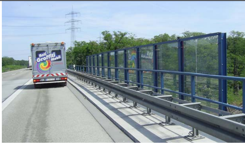
Bild 5/6: Anwendungsbeispiel: Reinigung Lärmschutzwand mit Acrylglasflächen.
